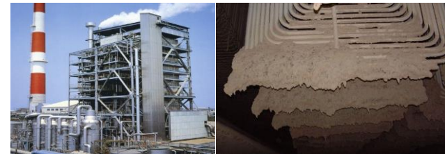
・大型火力発電ボイラーの外観 ・クリンカーの堆積した様子
