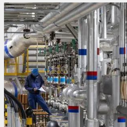
熱供給プラント (晴海アイランド地区)
