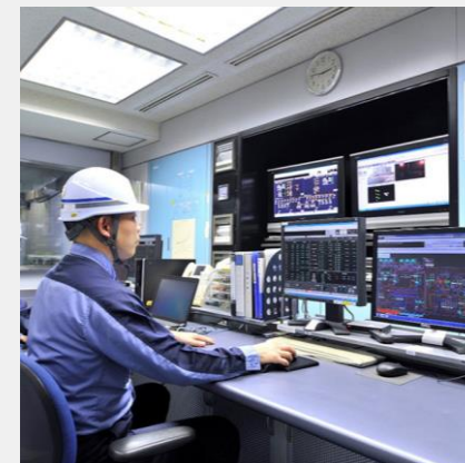
オペレーションルーム
