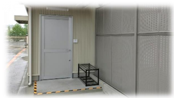
ICカード入退室システム
