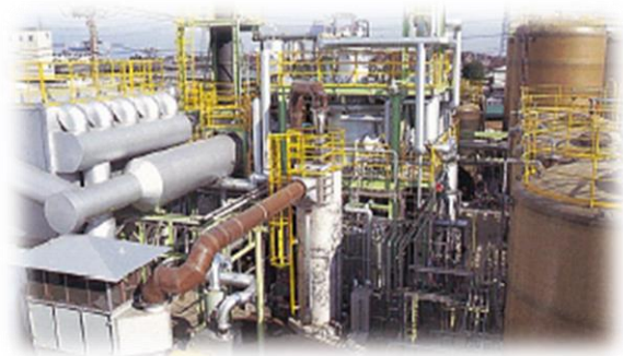
廃液濃縮・高温酸化処理設備（MCRシステム）
