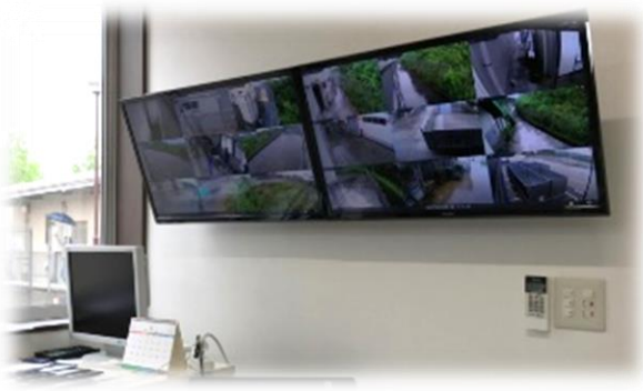
複数設置された場内監視カメラ
