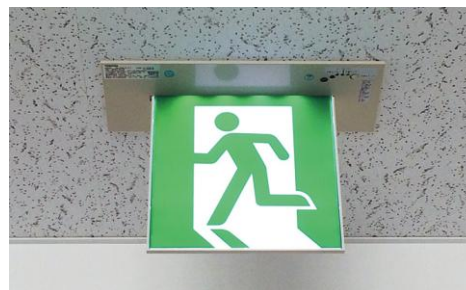
誘導灯の点検
