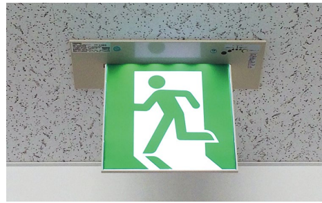
誘導灯の点検
