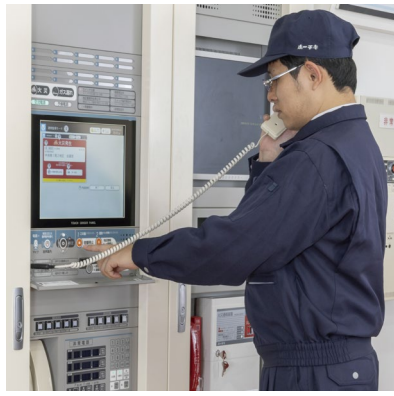
受信機の点検
