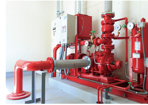
消火ポンプの点検
