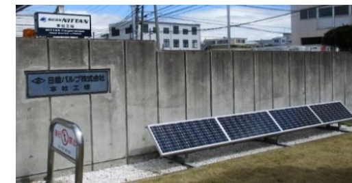
NITTAN 本社工場正門 太陽光パネル
