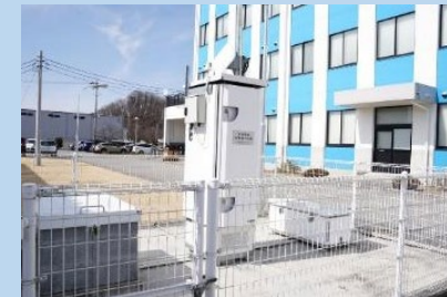
地震計試験設備
