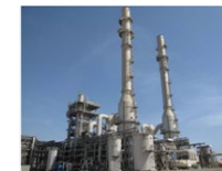
廃液燃焼 システム
