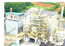
廃棄物処理設備
