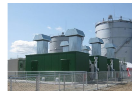
消化ガス発電設備
