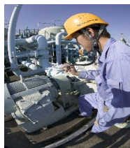
設備メンテナンス
