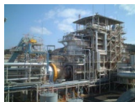
固形廃棄物処理設備
