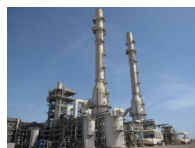
廃液燃焼システム
