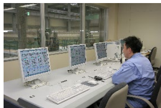
浄水場オペレーター室
