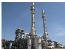
廃液燃焼システム
