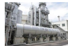
下水汚泥燃料化設備
