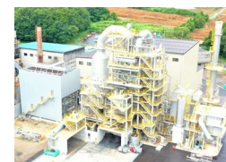
廃棄物処理設備
