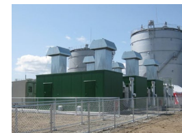
消化ガス発電設備
