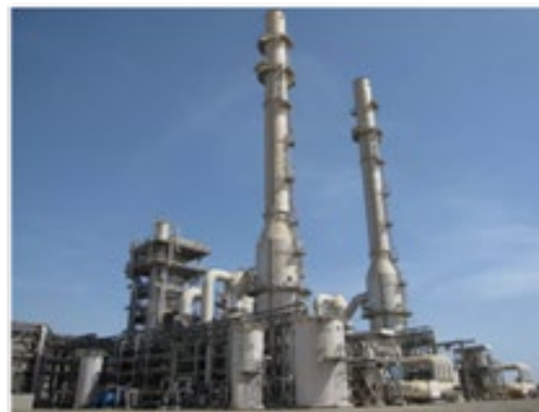
廃液燃焼システム
