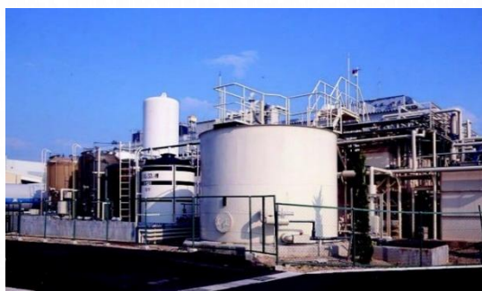
超純水製造装置(水処理プラント)
