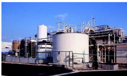
超純水製造装置(水処理プラント)
