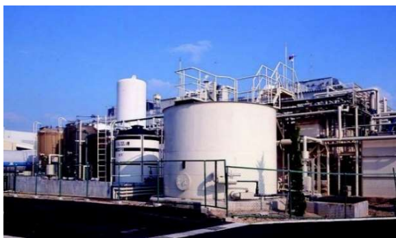
超純水製造装置(水処理プラント)
