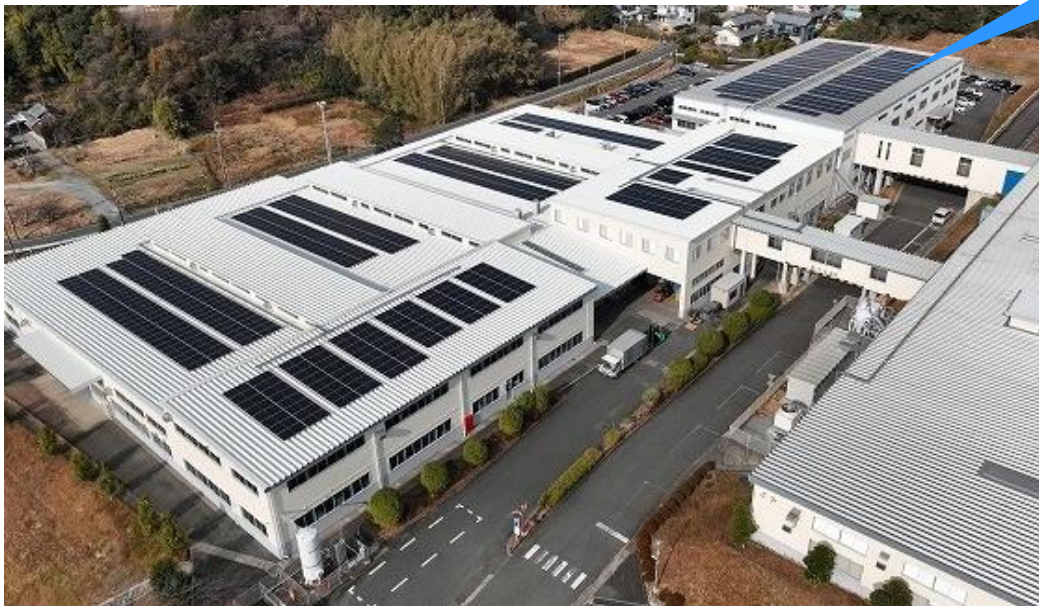
本社工場に設置した太陽光パネル
