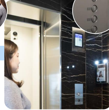
エレベーター
