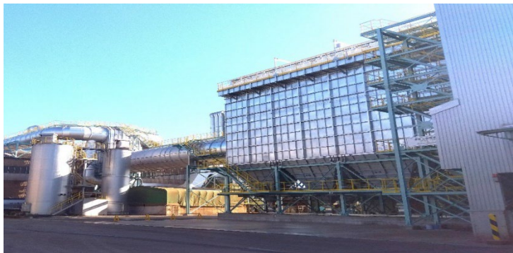
更新後の集塵機
