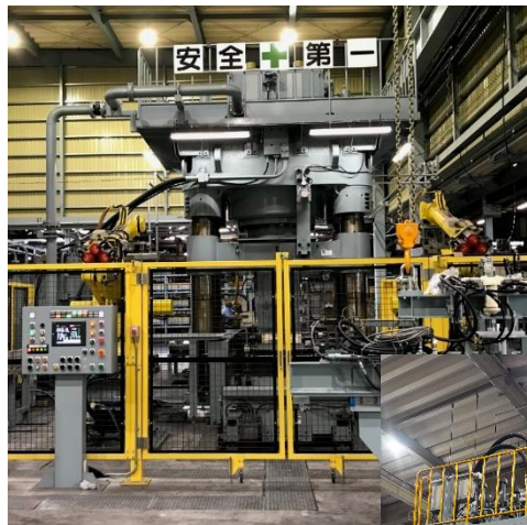
3,000Tプレス機 (日生工場)
