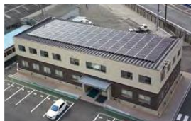
吉永工場（第一製造所） 2023年8月稼働・2024年12月稼働 発電量：512kW
