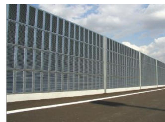
防音壁(吸音板)
