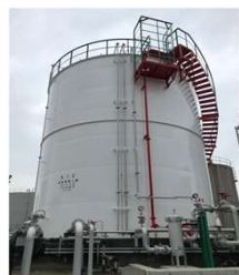
▲ 危険物タンク
