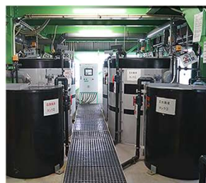
既存レアメタル回収設備
