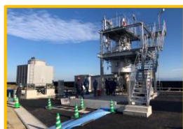
アライアンス先 蒸留再生設備
