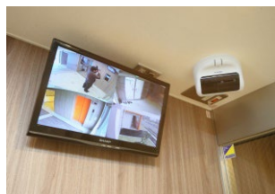
エントランス設置した防犯カメラ・モニター
