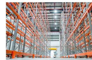
大規模倉庫用ラック
