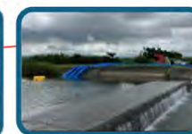
移動式排水システム
