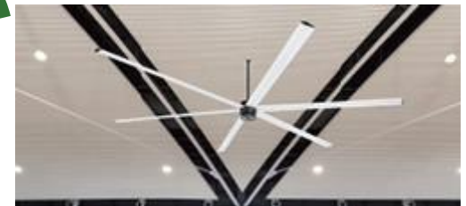
倉庫や大型屋内施設内の就労環境改善
