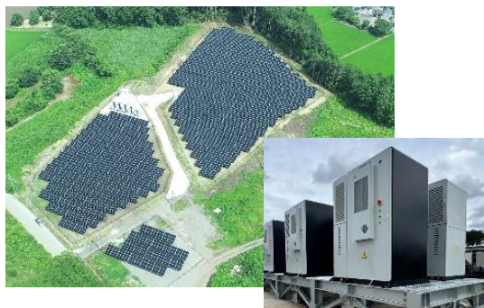
太陽光発電 (蓄電池併設型) (栃木県鹿沼市・非FIT)
