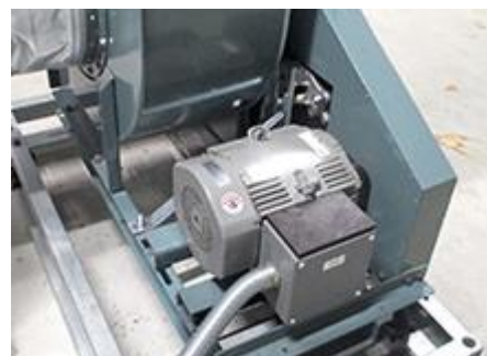
空調機吸排気ファン更新 (省エネ)
