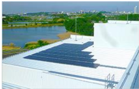
小牧工場太陽光発電設備 (省エネ)
