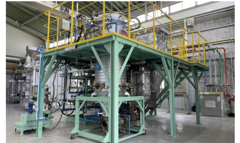
火炎内処理設備の受注も継続
