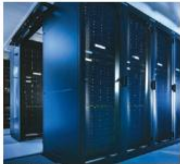
データセンター
