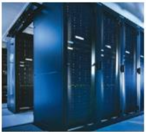
データセンター
