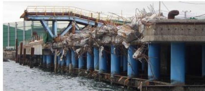
台風で船が漂流、棧橋に衝突・破損した状況
