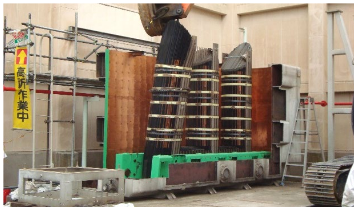
大型変圧器（トランス）
